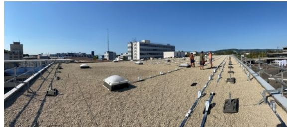
Lösung für schlechte Verbaubarkeit im Randbereich
