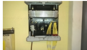
BEP (Building Entry Point) "Hausanschlusskasten", Zusammenführung Accesskabel mit Inhousekabel
