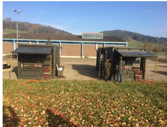
Schweizweit wurden 30 Logistikstandorte der Armee mit mobilen Ersatzstromanlagen ausgerüstet.
