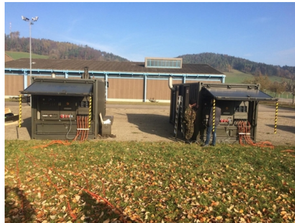
Schweizweit wurden 30 Logistikstandorte der Armee mit mobilen Ersatzstromanlagen ausgerüstet.
