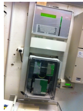
Résidence St-Martin - Local technique, centrale
