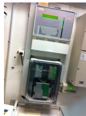
Résidence St-Martin - Local technique, centrale
