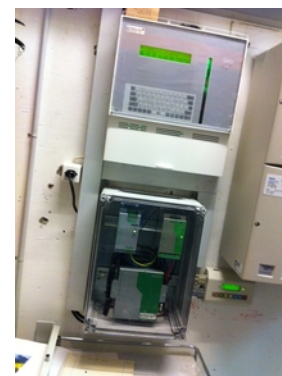
Résidence St-Martin - Local technique, centrale
