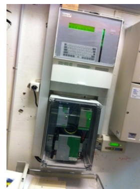
Résidence St-Martin - Local technique, centrale
