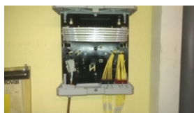
BEP (Building Entry Point) « Boîtier de distribution », regroupement du câble Access avec le câble Inhouse
