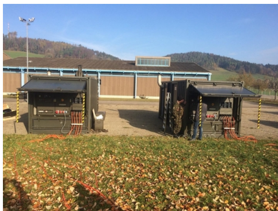
In tutta la Svizzera 30 sedi delle Forze Armate sono state fornite di impianti elettrici sostitutivi mobili
