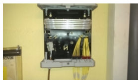
BEP (Building Entry Point) "Scatola di giunzione allacciamenti domestici", collegamento cavo di accesso con cavo inhouse
