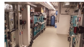
Impianto di aerazione
