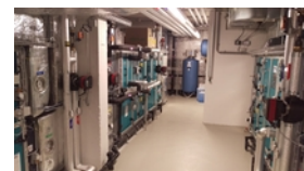
Impianto di aerazione
