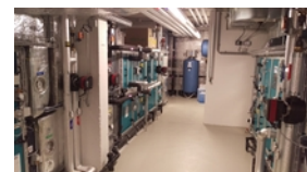
Impianto di aerazione
