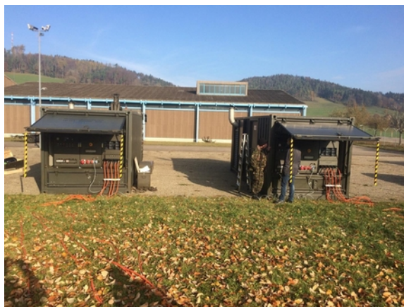
In tutta la Svizzera 30 sedi delle Forze Armate sono state fornite di impianti elettrici sostitutivi mobili
